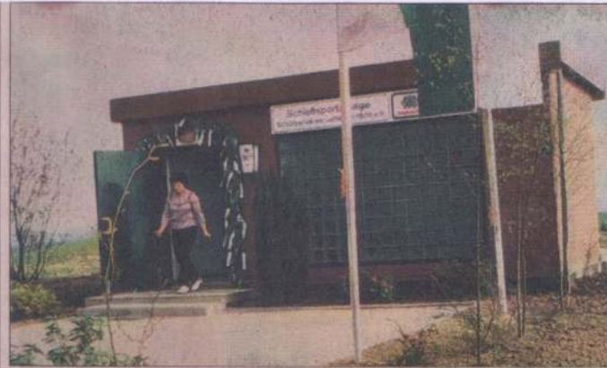
Das Treppenhaus zu den Schießständen – hier im Rohbau – muss zehn Jahre auf den Anbau des Schützenhauses warten.
